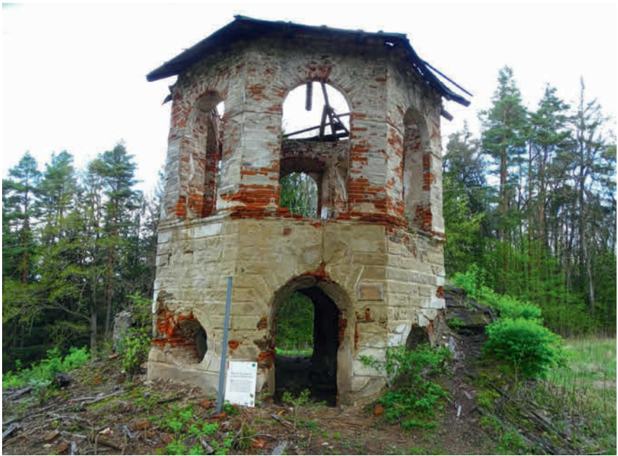
Abb. 3: Zustand der Teufelskirche im Mai 2023 (Süd-Ansicht). Quelle: R. Zappe, 2023.
